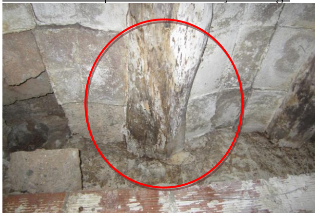
Biga 9S. Atac d'anòbid, de tèrmit inactiu i de fong de podridura tova. Atac de podridura tova fins a uns 100 cm a partir del cap de biga que es recolza a la paret. Falta un troç de biga. Es recomana substitució o substitució de la part afectada i reforç de la biga.
