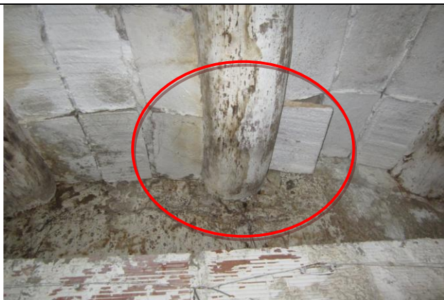
Biga 7s. Atac d'anòbid, de tèrmit inactiu i de fong de podridura tova. Atac de podridura tova fins a uns 50 cm a partir del cap de biga que es recolza a la paret. Es recomana substitució de la part afectada i reforç de la biga.
