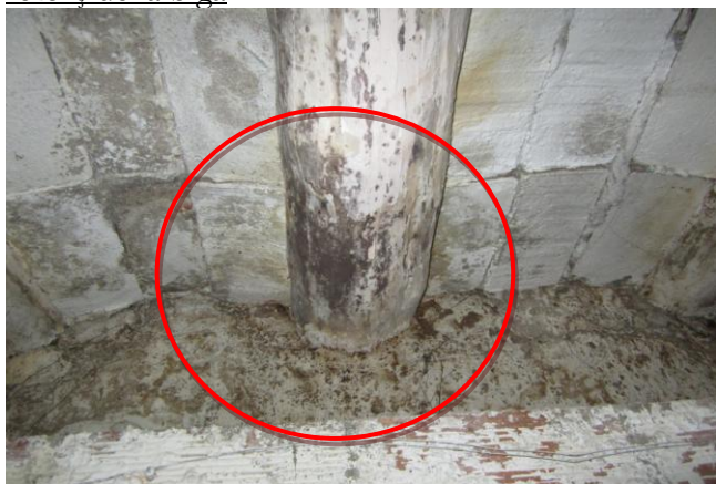
Biga 8s. Atac d'anòbid, de tèrmit inactiu i de fong de podridura tova. Atac de podridura tova fins a uns 70 cm a partir del cap de biga que es recolza a la paret. Biga afectada. Es recomana substitució o substitució de la part afectada i reforç de la biga.
