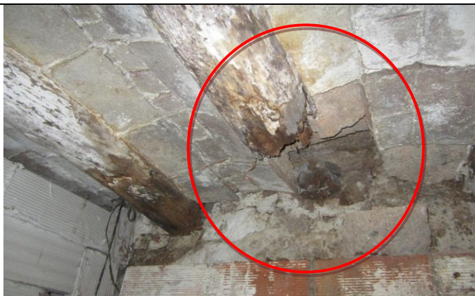
Biga 10S. Atac d'anòbid, de tèrmit inactiu i de fong de podridura tova. Atac de podridura tova fins a uns 100 cm a partir del cap de biga que es recolza a la paret. Biga molt afectada. Es recomana substitució o substitució de la part afectada i reforç de la biga.
